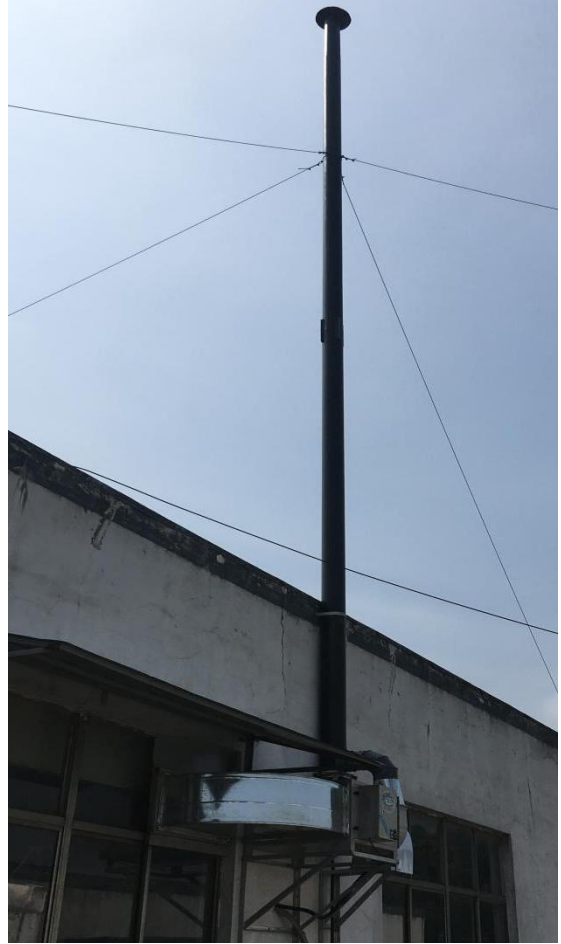
发泡废气排气筒
